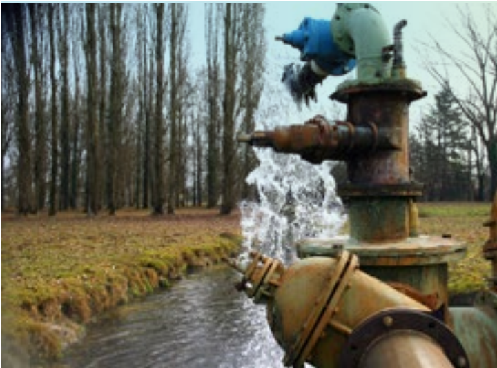
Veritas Area campo pozzi a Scorzè (VE)
